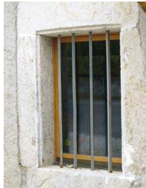
Usage insolite de vieilles bornes : elles servent maintenant de linteaux à cette fenêtre ! Cliché © J. P. Wisard – État de Genève.
